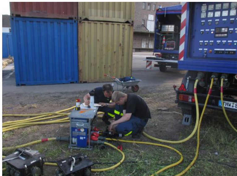
Aufbau der Stromversorgung vor Ort
