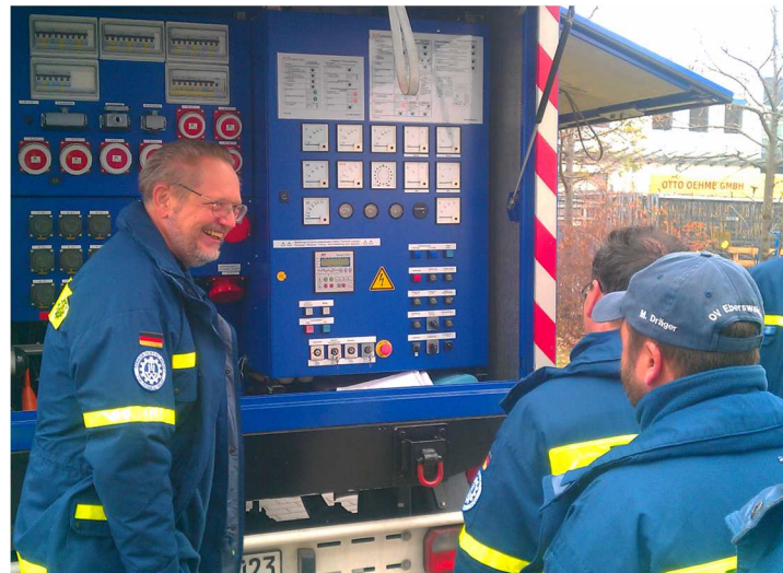
Gemeinsame Ausbildung an der Netzersatzanlage mit dem Ortsverband Berlin-Lichtenberg
